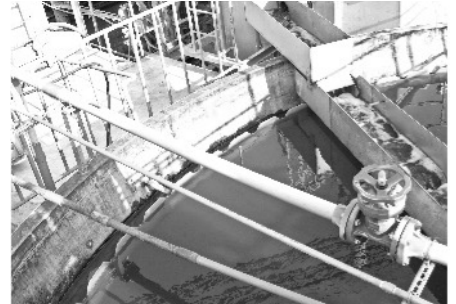
排水処理装置で環境基準をクリアして排水している
