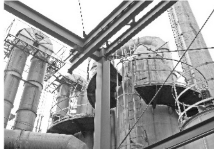
脱硫装置で排ガスから硫黄酸化物(SO x )を除去している
